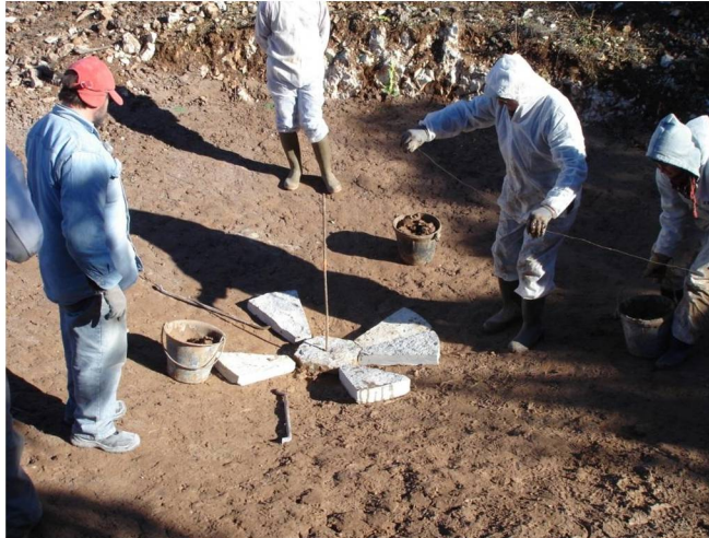
Le 1 er rang en cours de construction. La vérification des niveaux s'impose à chaque nouvelle dalle posée
