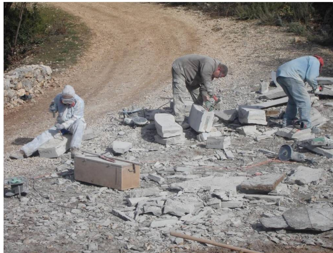
Le nombre de dalles à préparer nécessite la participation de plusieurs personnes pour le travail de taille
