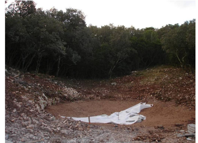
A chaque fin de journée, il faut installer la feutrine afin d'éviter le dessèchement de l'argile (pour plus d'efficacité, on humidifie la feutrine régulièrement)
