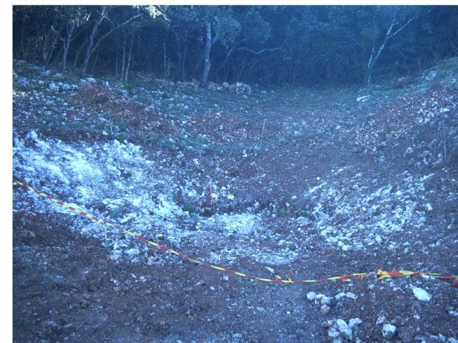
Aperçu du terrassement suite à l'intervention de la pelle mécanique de la mairie de Collias
